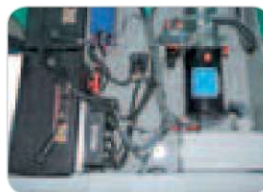
Montaggio della componentistica molto ordinato ed ergonomico per lo svolgimento della manutenzione.
